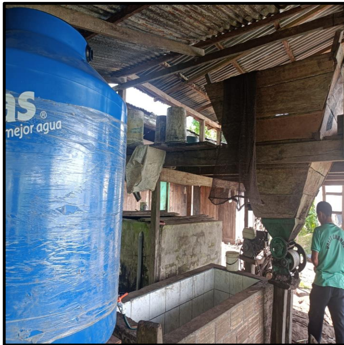
Fotografía N° 15. Instalación del tanque rotaplas de 1100 litros para almacenamiento de agua sobrante del reservorio dirigido al lavado de “café”.
