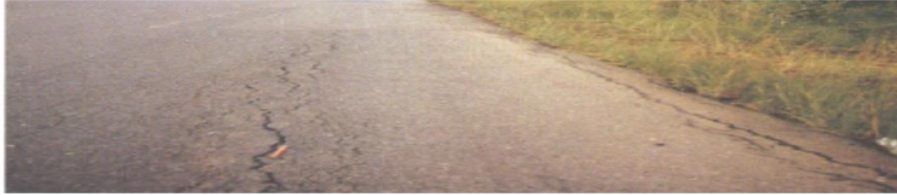
Figura 4: Fisuras longitudinales. Gravedad 3: Fisuras gruesas, corresponden a fisuras abiertas y/o ramificadas (ancho > 3mm). También se denominan grietas
