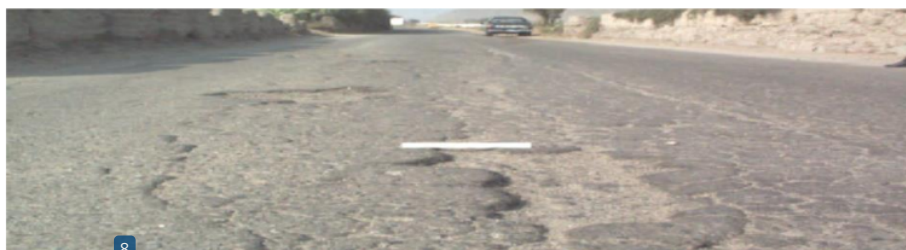
Figura 11: Baches (Huecos). Gravedad 2: Diámetro entre 0.2 y 0.5 m.
