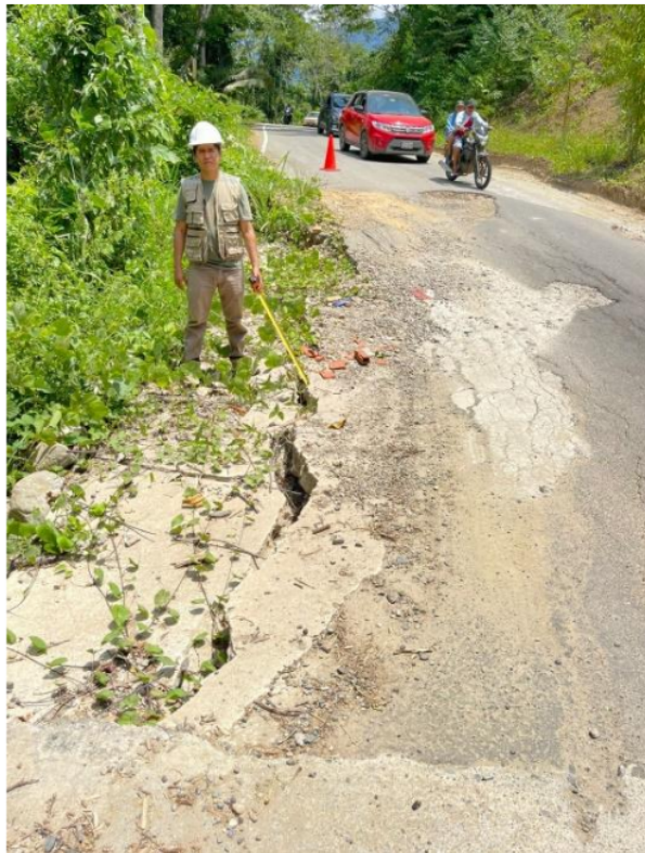
Fotografía 16. Se observa al tesista identificando una falla estructural o geotécnica, debido a que existe asentamiento y destrucción de la capa de rodadura y pérdida de material, haciendo que los usuarios reduzcan drásticamente la velocidad e invadir el siguiente carril.
