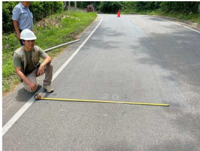
Fotografía 14. Se observa al tesista, identificando la patología de ahuellamiento reparado entre la progresiva KM 7+840 y 7+900.
