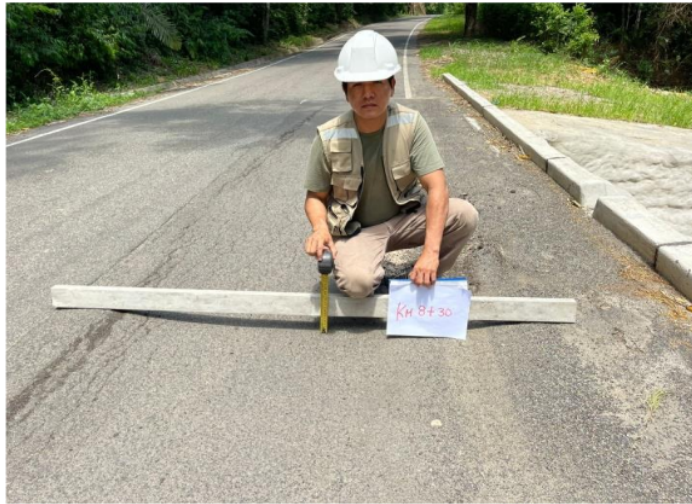
Fotografía 15. Se observa al tesista en la progresiva KM 8+030, identificando la patología de deformación por deficiencia estructural. Esta patología se encuentra en una zona donde se realizó trabajo de mantenimiento recientemente.
