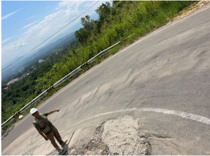
Fotografía 5. Se observa al tesista reconociendo las patologías de baches en la progresiva KM 01+980.
