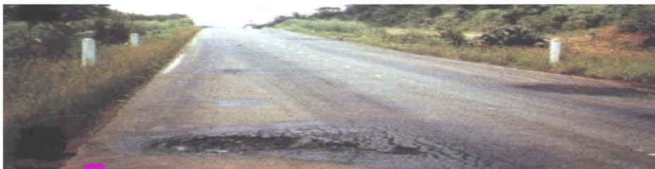
Figura 10: Reparaciones o parchado. Gravedad 3: Reparación de piel de cocodrilo o de fisuras longitudinales, en mal estado.
