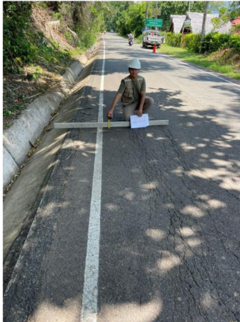
Fotografía 12. Se observa al tesista identificando la patología 14 de piel de cocodrilo de gravedad 3, en la progresiva KM 5+300.
