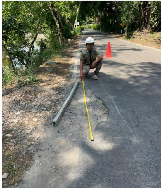
Fotografía 3. Se observa al tesista identificando y realizando la medición de la patología encontrada en la progresiva KM 00+500.
