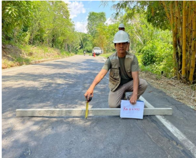
Fotografía 13. Se observa al tesista en la progresiva KM 6+700, identificando que en esta sección se realizaron trabajos de mantenimiento, específicamente recapeo. Aunque existe deformación de 1.5 cm.
