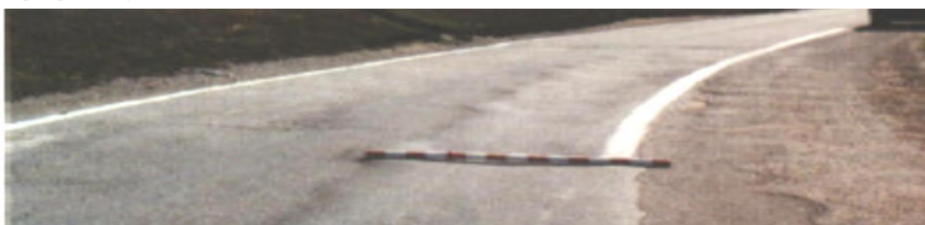
Figura 9: Ahuellamiento. Se observa un levantamiento de materiales formando cordones a lo largo del trazado de las ruedas. Gravedad 3: Profundidad > 12 mm.
