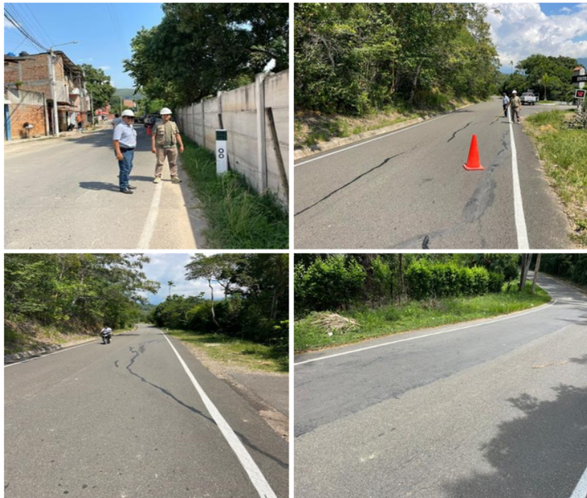
Figura 15: Reconocimiento e identificación de patologías en el tramo de investigación. Se aprecia el inicio, fisuras y ahuellamientos tratados. Fuente: Elaboración propia, (2023)
