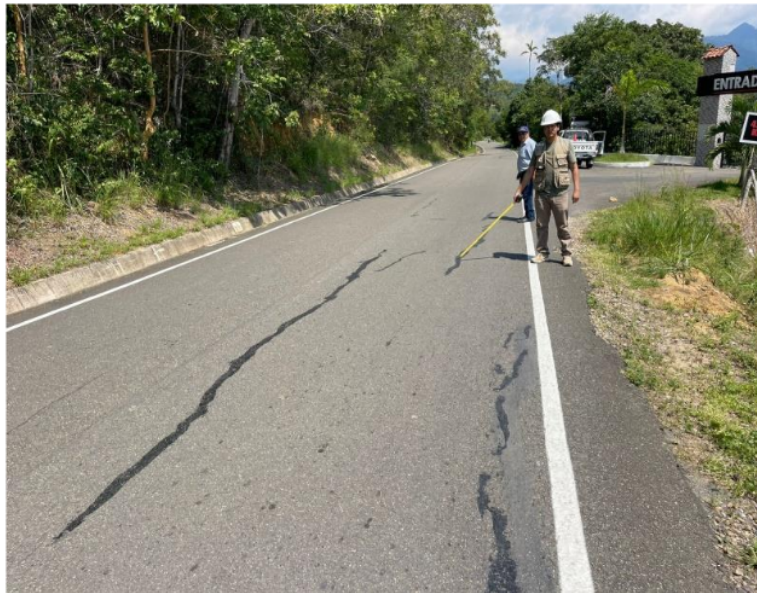
Fotografía 8. Se visualiza al tesista identificando que se realizaron trabajos de mantenimiento a las fisuras longitudinales en la progresiva KM 4+500.
