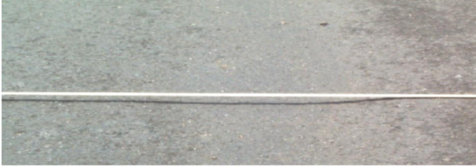
Figura 7: Deformaciones (3a depresión continua longitudinal). Gravedad 2: Profundidad entre 2 cm y 4 cm
