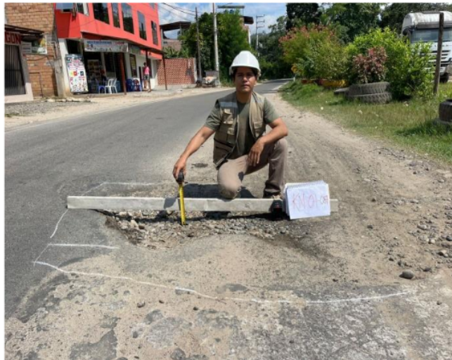
Fotografía 2. Se visualiza al tesista identificando la patología de "bache" en la progresiva en la progresiva KM 0+087.
