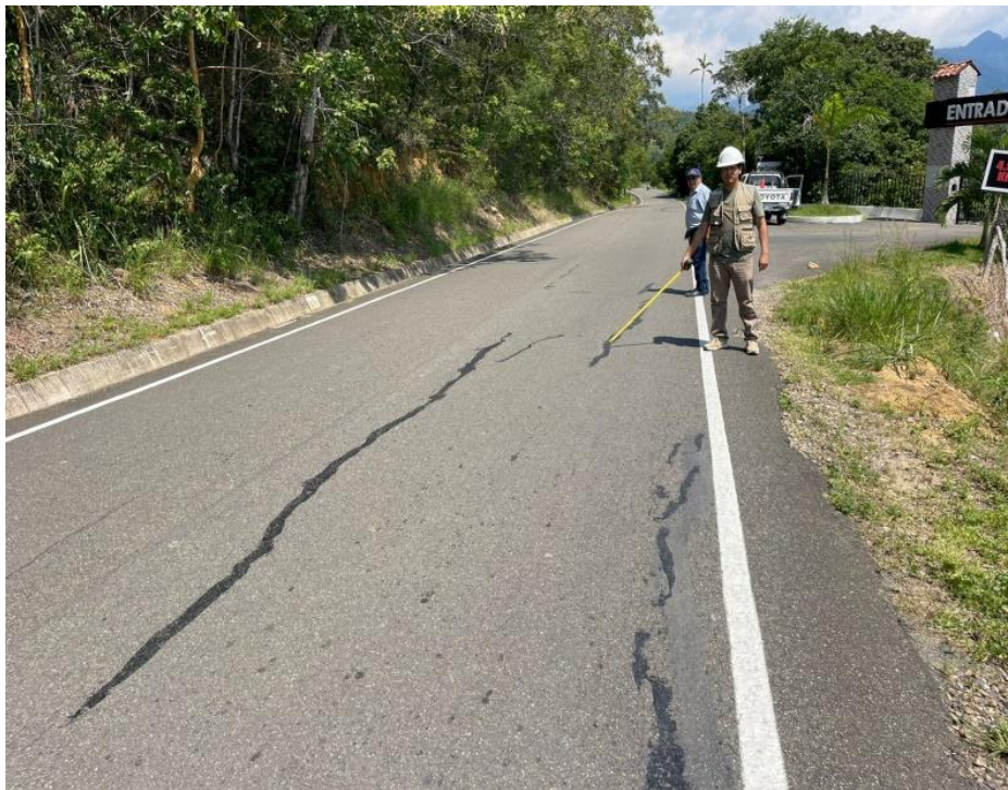
Fotografía 8. Se visualiza al tesista identificando que se realizaron trabajos de mantenimiento a las fisuras longitudinales en la progresiva KM 4+500.
