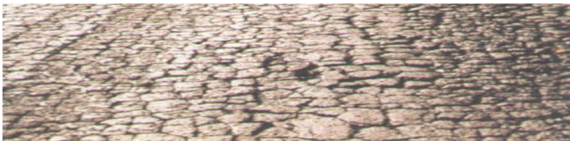
Figura 6: Piel de cocodrilo. Gravedad 3: Malla pequeña (< 0.3 m) sin o con material suelto
