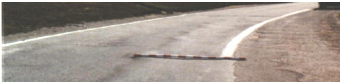
Figura 9: Ahuellamiento. Se observa un levantamiento de materiales formando cordones a lo largo del trazado de las ruedas. Gravedad 3: Profundidad > 12 mm.
