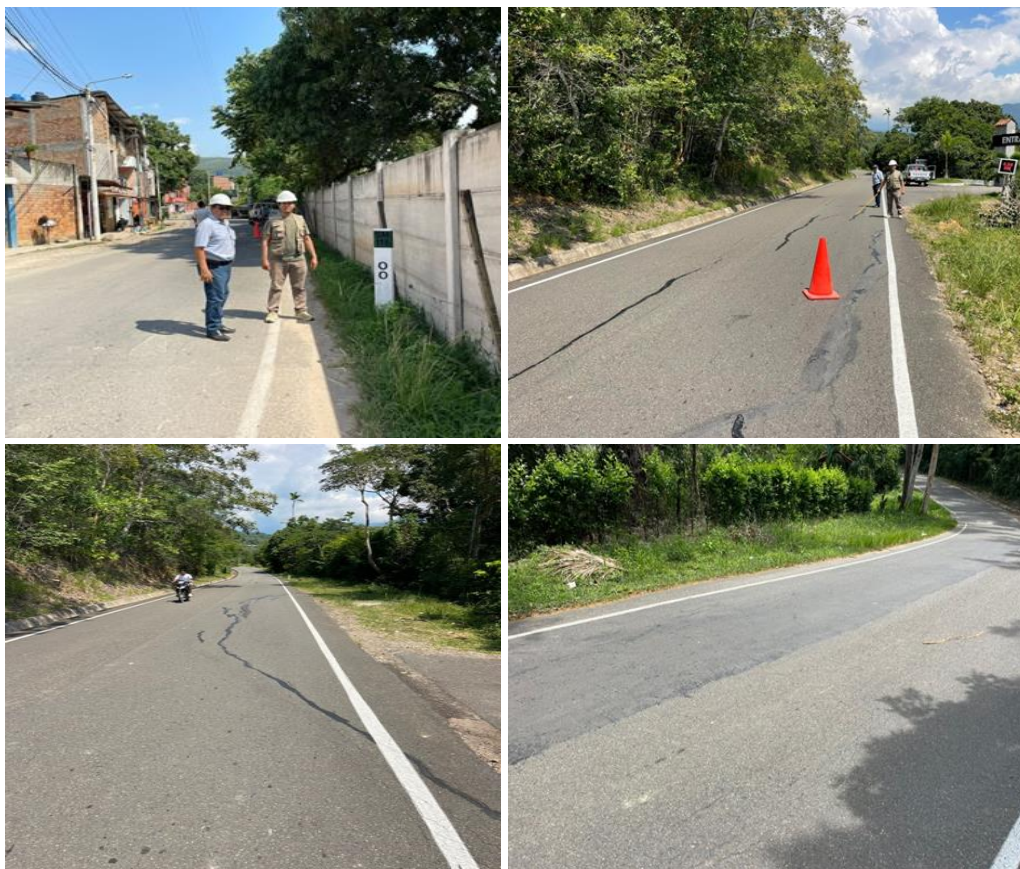
Figura 15: Reconocimiento e identificación de patologías en el tramo de investigación. Se aprecia el inicio, fisuras y ahuellamientos tratados.
