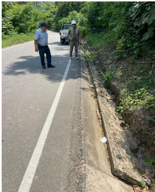
Fotografía 18. Se visualiza al tesista y al asesor de tesis inspeccionando las patologías ocasionadas por falta de mantenimiento de parte de la Entidad encargada del tramo de estudio
