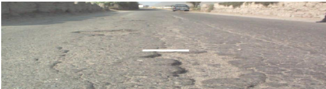
Figura 11: Baches (Huecos). Gravedad 2: Diámetro entre 0.2 y 0.5 m.
