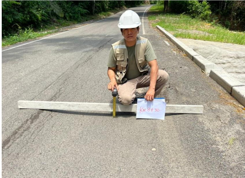
Fotografía 15. Se observa al tesista en la progresiva KM 8+030, identificando la patología de deformación por deficiencia estructural. Esta patología se encuentra en una zona donde se realizó trabajo de mantenimiento recientemente.
