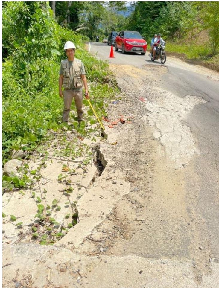
Fotografía 16. Se observa al tesista identificando una falla estructural o geotécnica, debido a que existe asentamiento y destrucción de la capa de rodadura y pérdida de material, haciendo que los usuarios reduzcan drásticamente la velocidad e invadir el siguiente carril.
