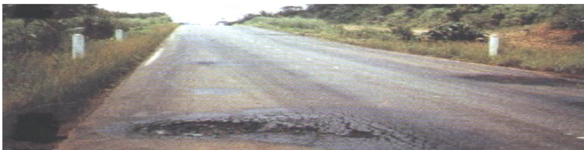
Figura 10: Reparaciones o parchado. Gravedad 3: Reparación de piel de cocodrilo o de fisuras longitudinales, en mal estado.
