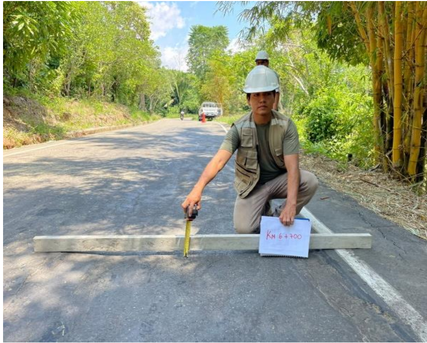
Fotografía 13. Se observa al tesista en la progresiva KM 6+700, identificando que en esta sección se realizaron trabajos de mantenimiento, específicamente recapeo. Aunque existe deformación de 1.5 cm.
