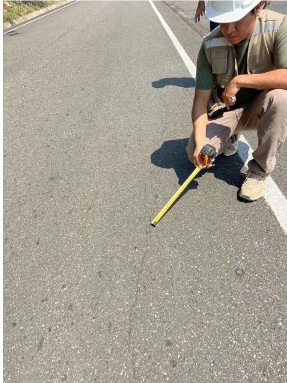
Fotografía 9. Se visualiza al tesista identificando la patología de fisuras longitudinales en la progresiva KM 4+500.
