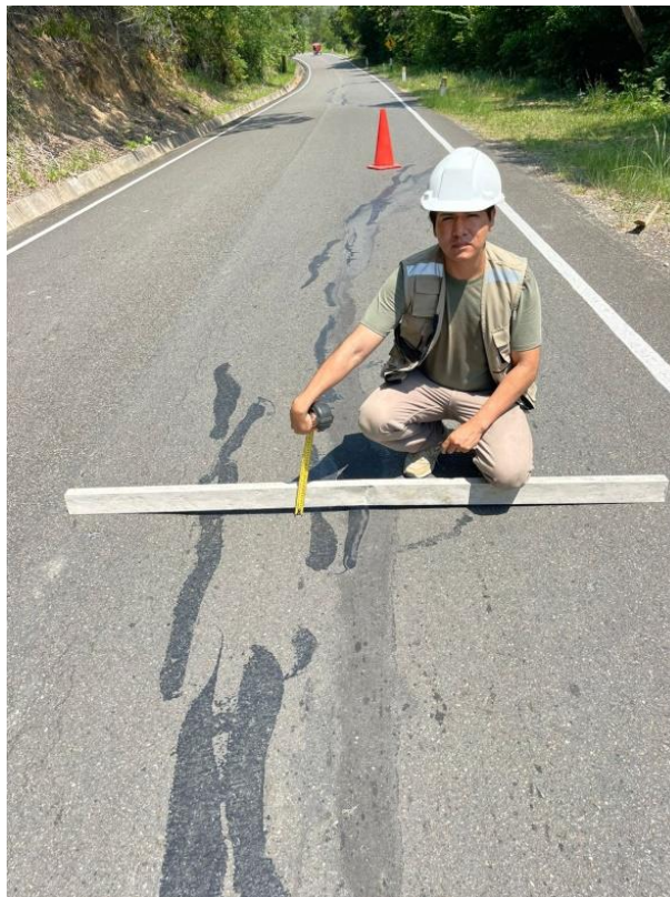
Fotografía 10. Se visualiza al tesista identificando la patología de deformación por falla estructural de 2 cm de profundidad, también en la progresiva KM 4+500
