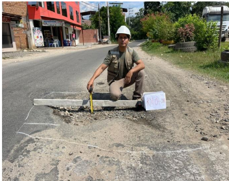
Fotografía 2. Se visualiza al tesista identificando la patología de "bache" en la progresiva en la progresiva KM 0+087.
