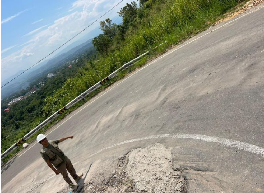
Fotografía 5. Se observa al tesista reconociendo las patologías de baches en la progresiva KM 01+980.
