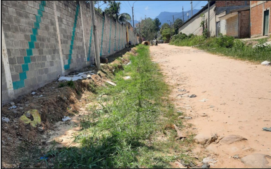
Figura 221. En la imagen se aprecia las cunetas construidos empíricamente por los pobladores ubicado al margen derecho de la cdra. 8 del jr. Circunvalación cumbaza (Fuente: Elaboración propia)
