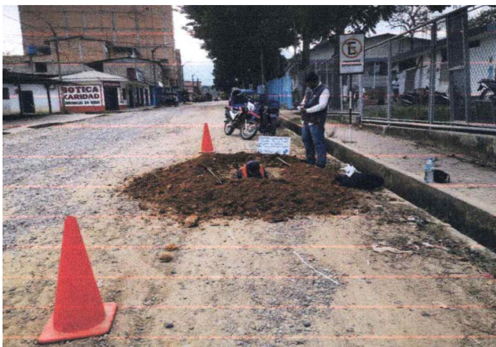
Figura 19. Excavación de la calicata N° 01, en el Jr. Pajaten C-03 del Distrito de la Banda de Shilcayo.
