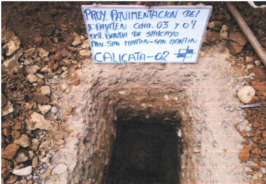
Figura 20. Excavación de la calicata N° 02, en el Jr. Pajaten C-04 del Distrito de la Banda de Shilcayo.
