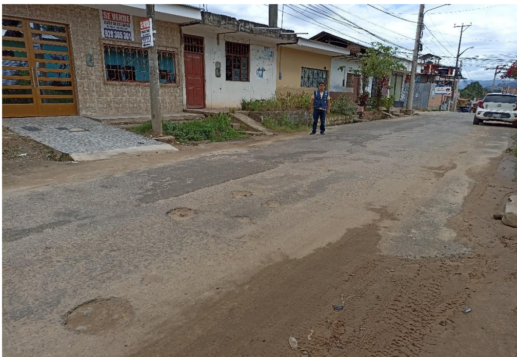
Fotografía 1: Se visualiza al tesista en el Jr. Alfonso Ugarte Cuadra – 1 identificando el conjunto de deterioros/fallas de baches y reparaciones.
