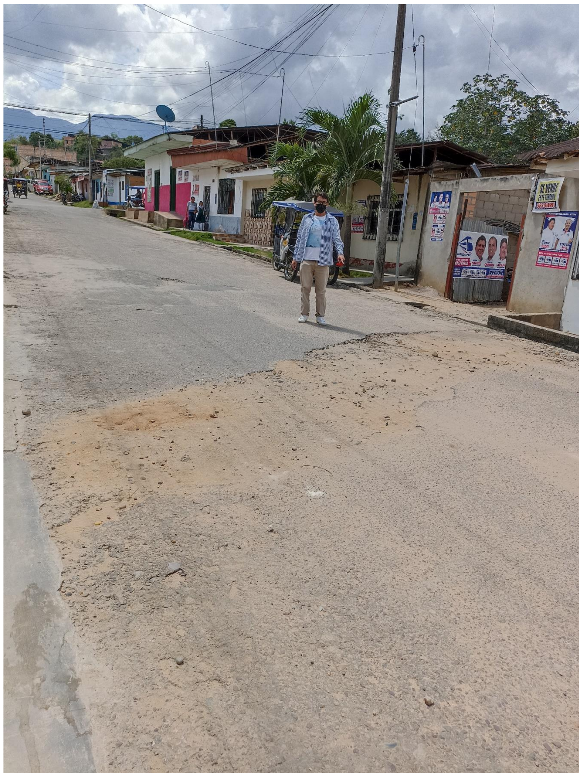
Fotografía 15: Se observa al tesista en el Jr. Bolívar Cuadra – 1, identificando una falla que posiblemente sea por la reparación o instalación del servicio de desagüe por parte de la EPS.
