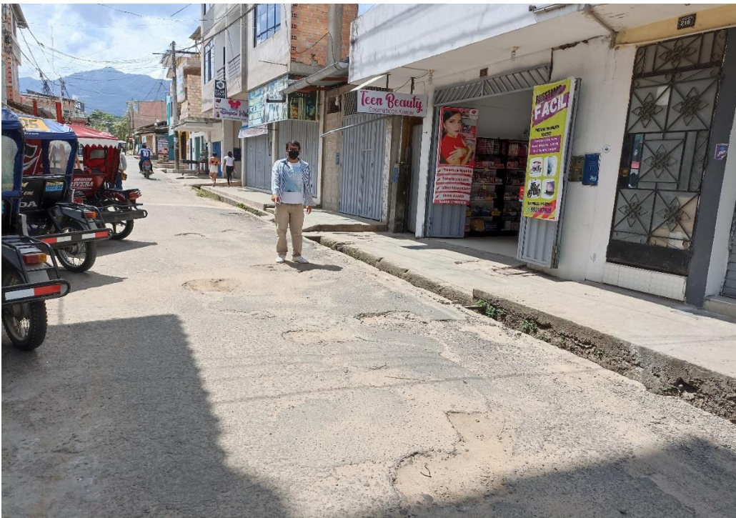
Fotografía 14: Se visualiza al testista un conjunto de deterioros/fallas de baches y reparaciones en el Jr. José Olaya Cuadra – 1
