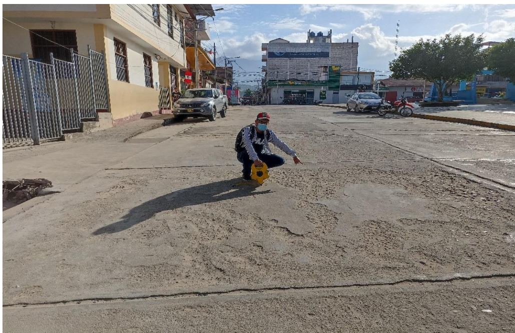
Fotografía 7: Se observa al tesista junto a los deterioros/fallas de desprendimiento y despostillamiento de juntas en el Jr. Augusto B. Leguía Cuadra – 1.
