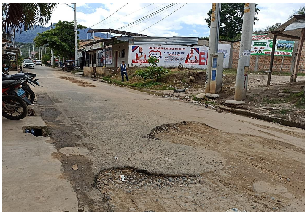
Fotografía 4: Se observa al tesista junto al conjunto de deterioros/fallas de baches de gravedad 3 y reparaciones. En el Jr. Leticia Cuadra - 2.
