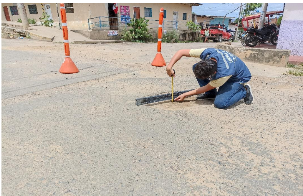
Fotografía 8: Se visualiza al tesista realizando la medición de la profundidad del bache en Jr. Alfonso Ugarte Cuadra – 4. Mismo que presenta una profundidad de 3 cm.
