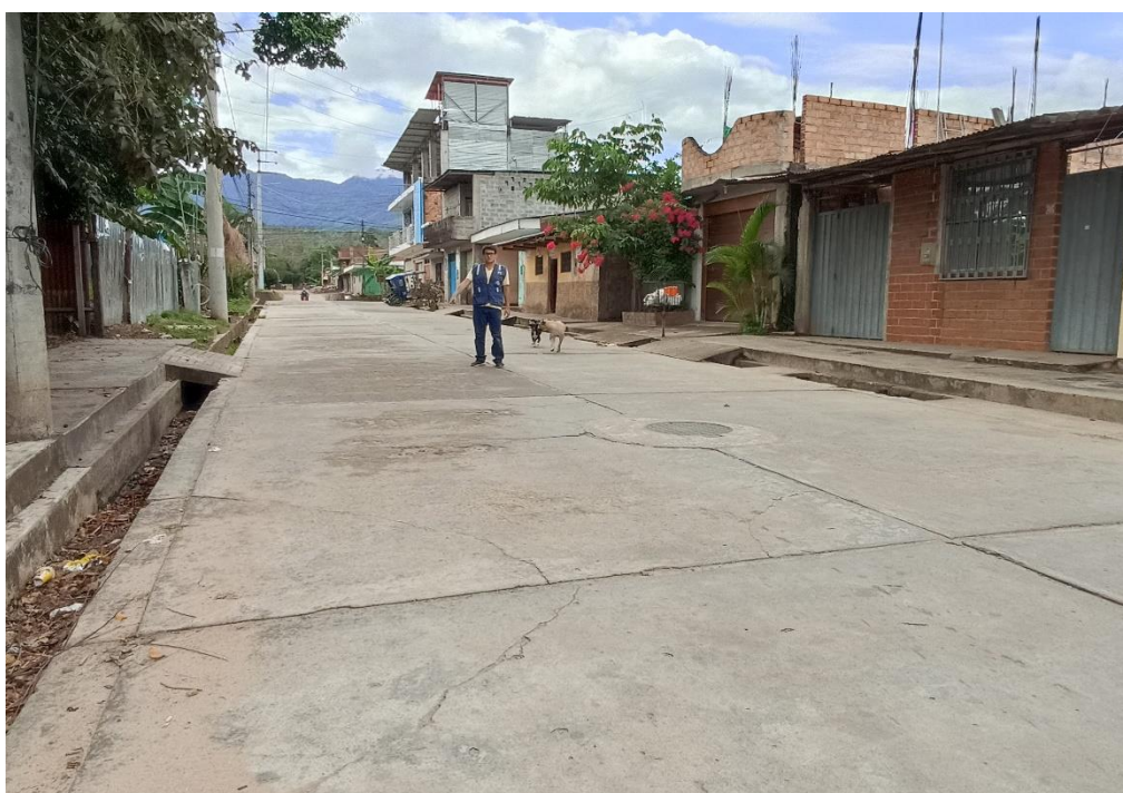
Fotografía 2: Se observa al tesista indicando los deterioros/ fallas de fisuras en esquinas, transversales, desprendimientos y despostillamiento de juntas. En el Jr. Cuzco Cuadra – 1.
