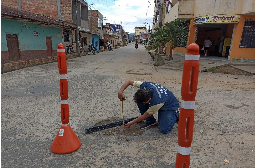
Fotografía 5: Se observa al tesista indicando el deterioro/falla de bache, de gravedad 3 en la intersección de los jirones Leticia y Sargento Lores, de profundidad 5cm
