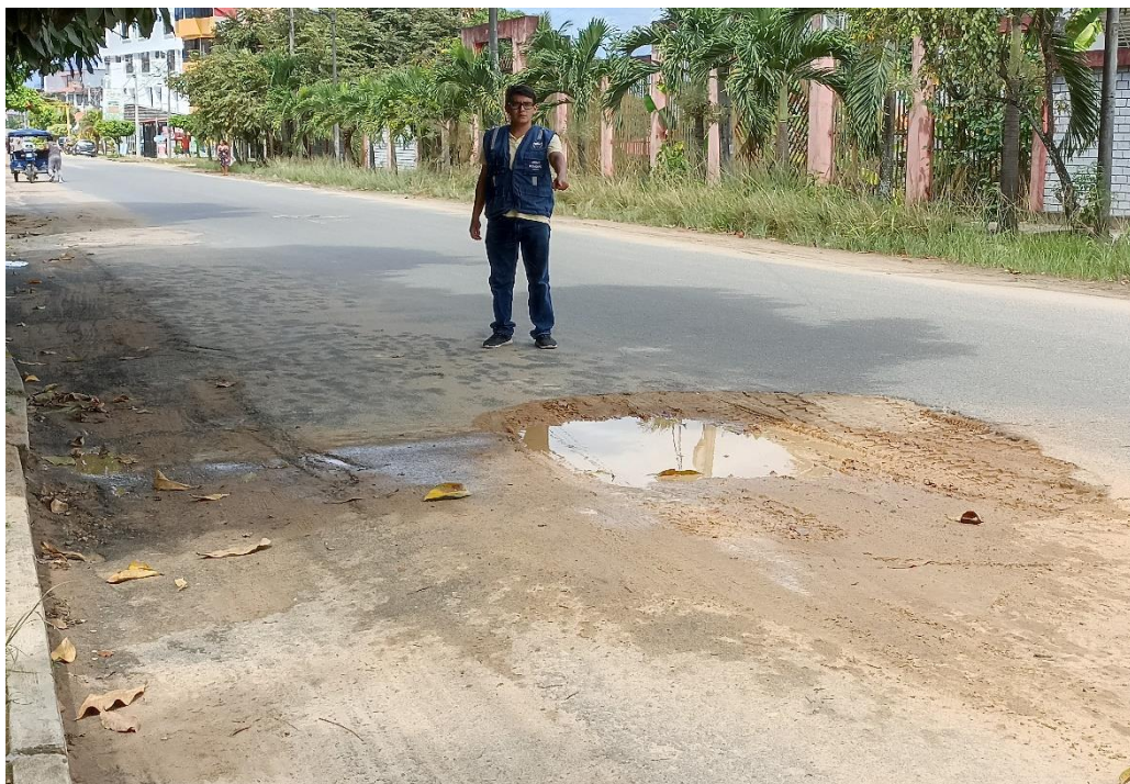
Fotografía 3: Se observa al tesista indicando el deterioro/falla de bache, de gravedad 3 en el Jr. Comandante Chirinos Cuadra - 4.
