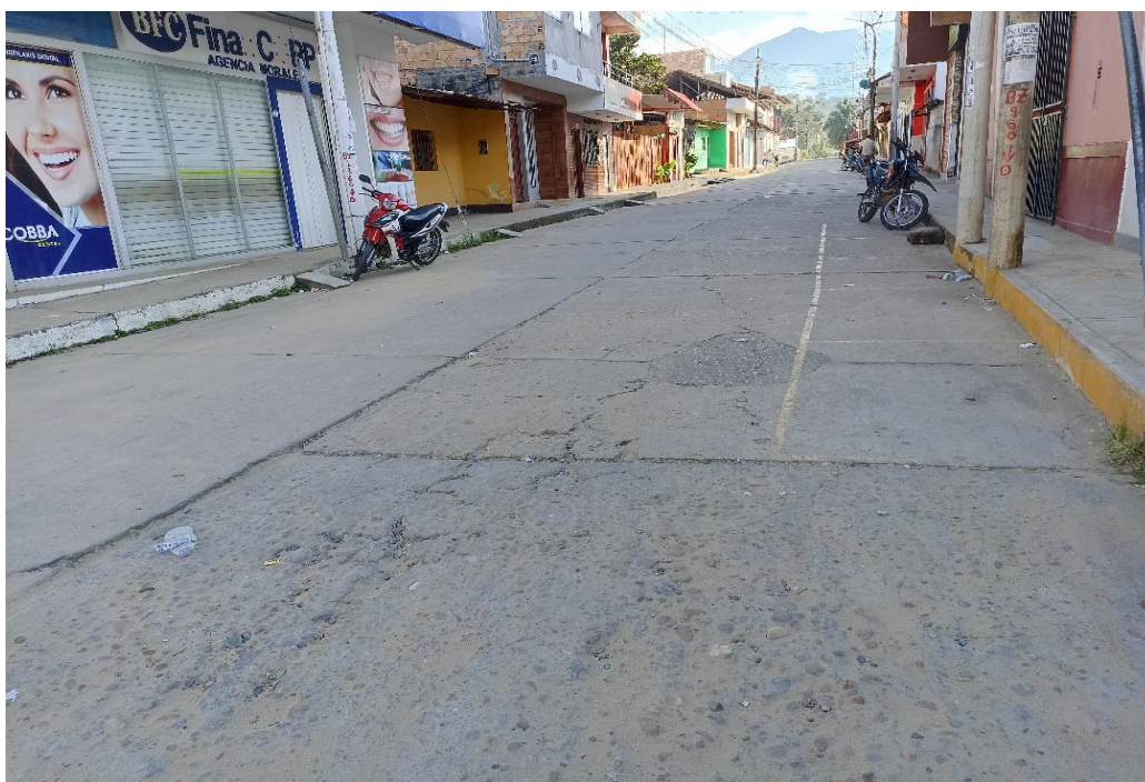
Fotografía 10: Se observa el Jr. Augusto B. Leguía Cuadra – 2 las fallas/deterioro de desprendimiento, fisuras longitudinales y reparaciones.
