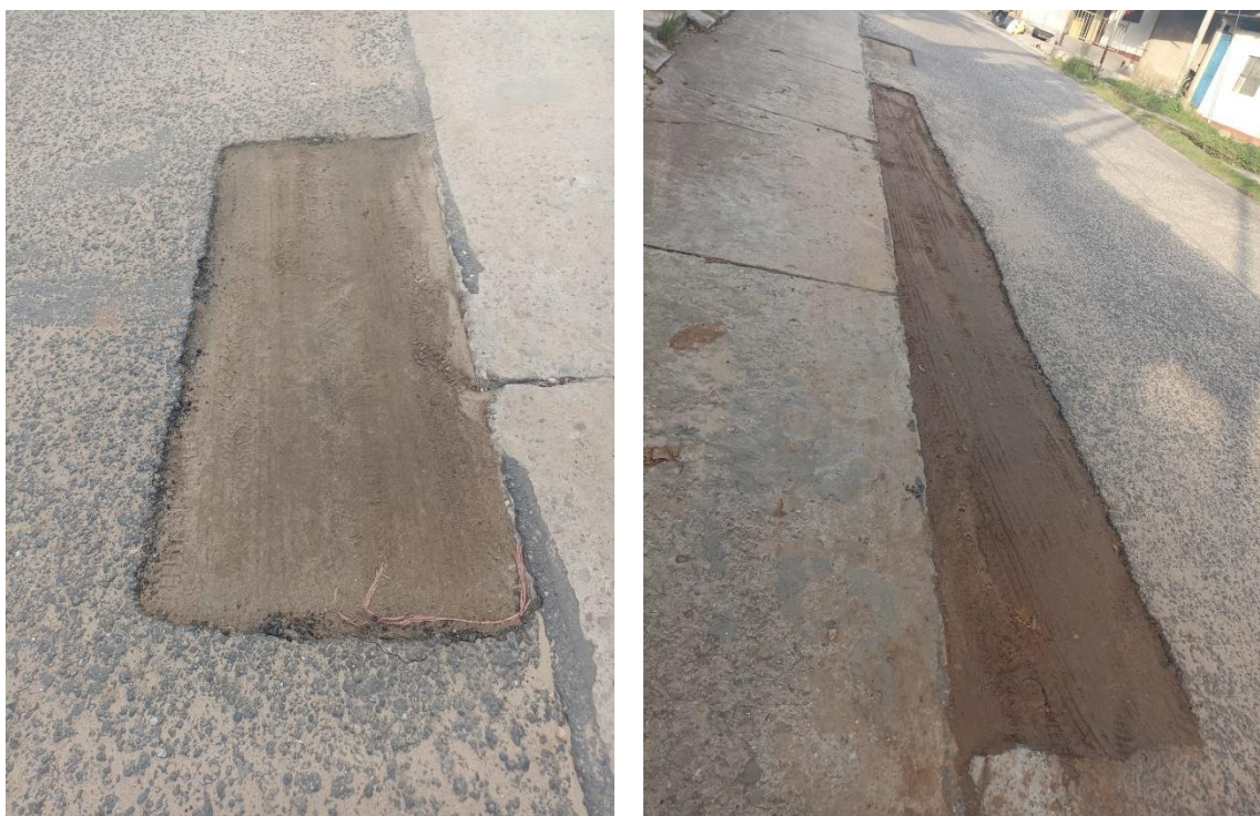
Figura 8: Reparación de baches en el Jr. Lorenzo Morales Cuadra 02 de la Urb. Fonavi. El color que se muestra se debe a que después del compactado ha caído una lluvia y el agua ha discurrido sobre estos ya que no ha sido colocada la carpeta asfáltica.
