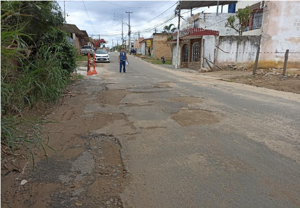
Fotografía 13: Se visualiza al testista un conjunto de deterioros/fallas de baches y reparaciones en el Jr. José Olaya Cuadra – 1
