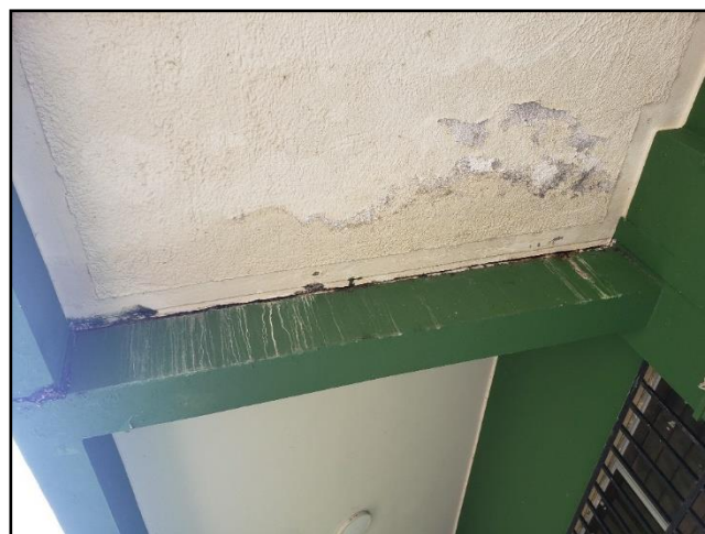
Foto N° 10: Presencia de humedad en la losa del segundo nivel del Pabellón de Aulas de la Facultad de Ciencias Agrarias (Fuente: Elaboración propia)
