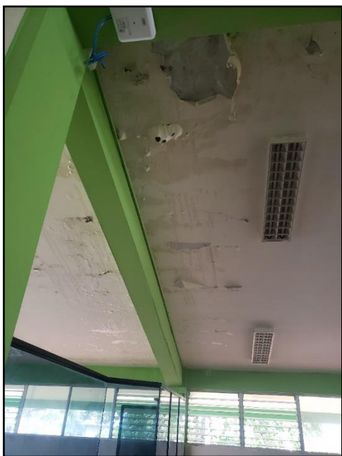
Foto N° 09: Presencia de humedad en la losa del segundo nivel del Pabellón Administrativo 02 de la Facultad de Ingeniería Agroindustrial (Fuente: Elaboración propia)
