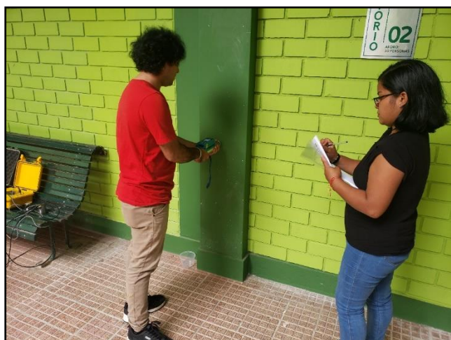
Foto N° 18: Realizando el ensayo de esclerometría con el equipo electrónico en las columnas del Pabellón de Laboratorios y Gabinetes de la Facultad de Ciencias Agrarias (Fuente: Elaboración propia)
