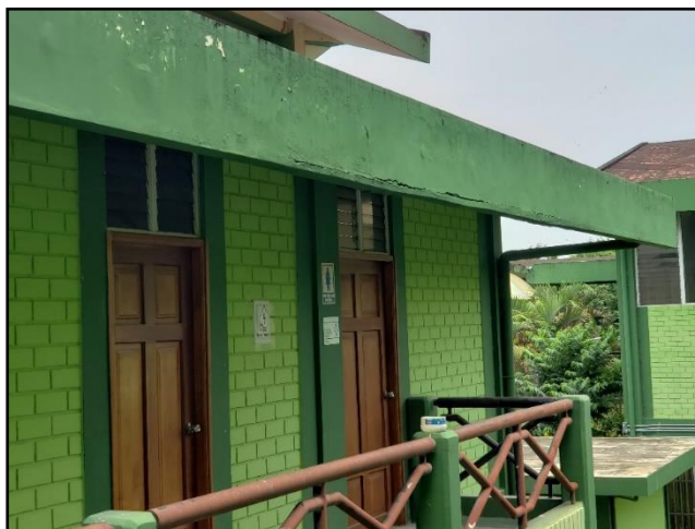
Foto N° 15: Desprendimiento del concreto en vigas del segundo nivel del Pabellón de SS-HH de la Facultad de Ciencias Agrarias (Fuente: Elaboración propia)
