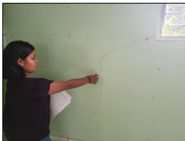
Foto N° 12: Presencia de paredes fisuradas por falta de confinamiento y aislamiento entre las paredes colindantes y las ventanas del segundo nivel del Pabellón Administrativo 01 de la Facultad de Ciencias Agrarias (Fuente: Elaboración propia)
