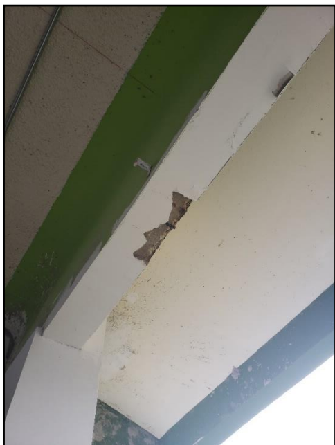
Foto N° 16: Desprendimiento del concreto y la exposición de acero de refuerzo en vigas del segundo nivel del Pabellón de Laboratorios y Gabinetes de la Facultad de Ingeniería Agroindustrial (Fuente: Elaboración propia)
