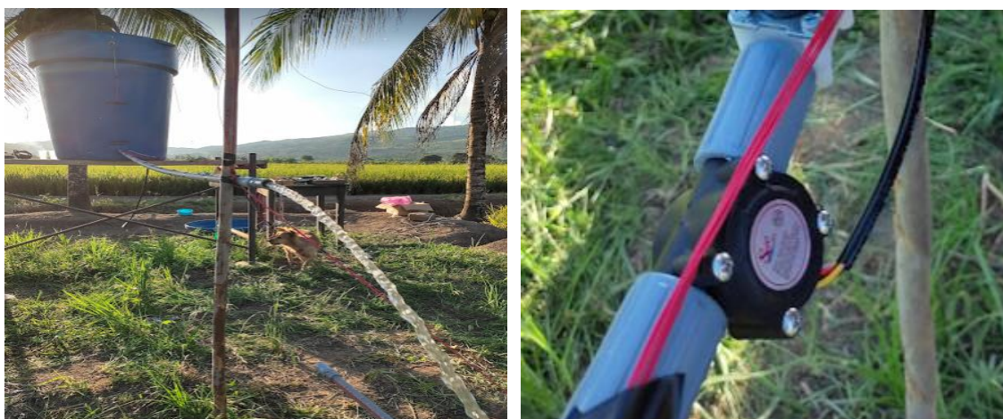
Figura 16. Instalación del sensor de flujo de agua (YF-S201)
