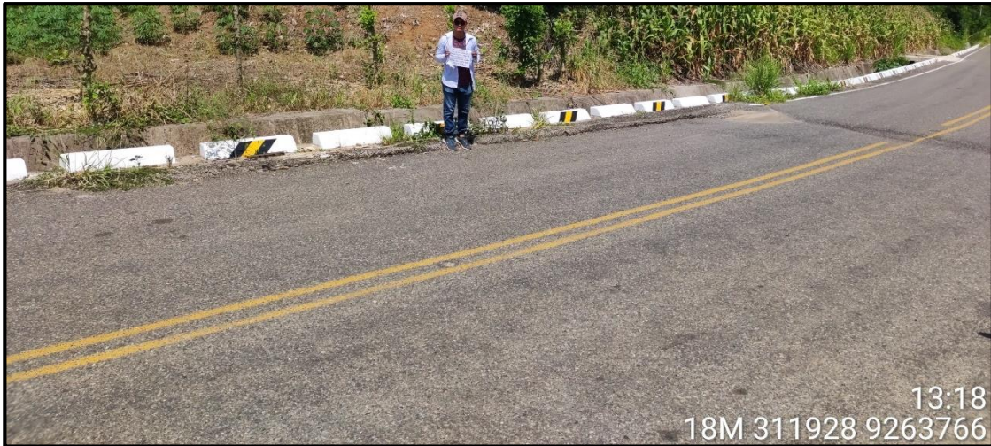
Figura 18. Deformaciones por Deficiencia Estructural (Hundimiento) – km 6+520
