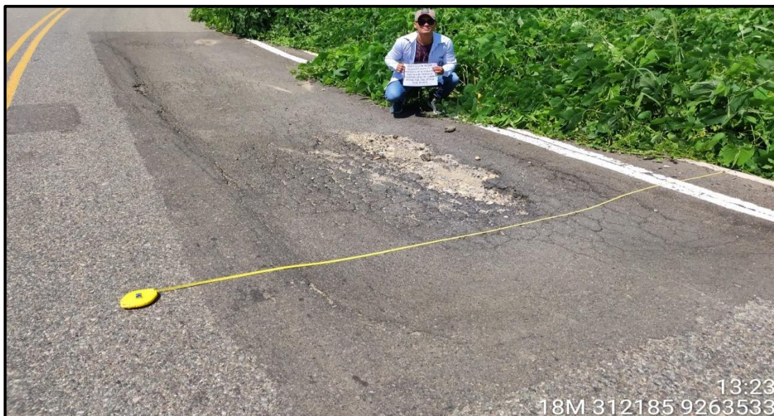
Figura 19. Reparaciones o Parchado – km 7+015
