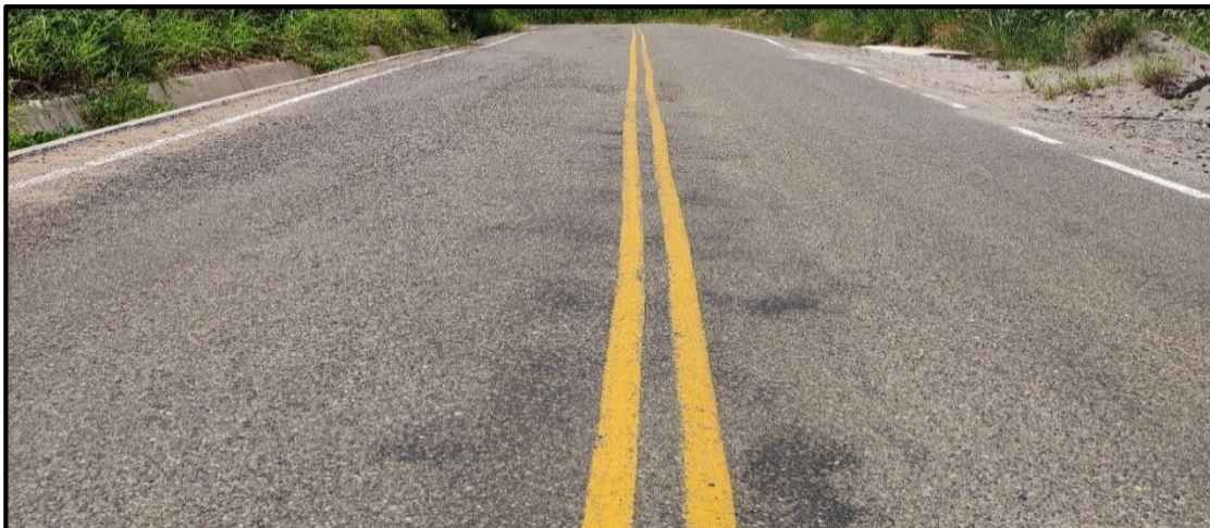
Figura 16. Peladura y Desprendimiento de Agregados – km 5+805
