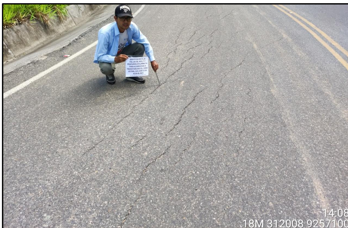
Figura 28. Fisuras Longitudinales – km 15+510
