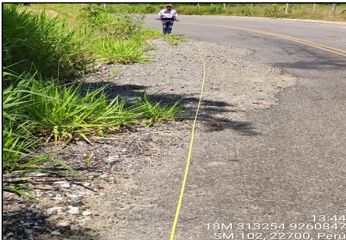
Figura 24. Peladura y Desprendimiento de Agregados – km 10+530
