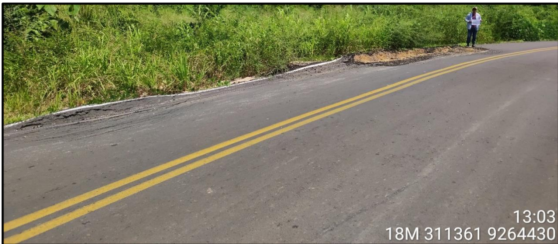
Figura 14. Deformaciones por Deficiencia Estructural (Hundimiento) – km 5+730
