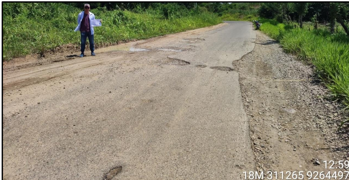
Figura 13. Peladura y Desprendimiento de Agregados – km 5+510
