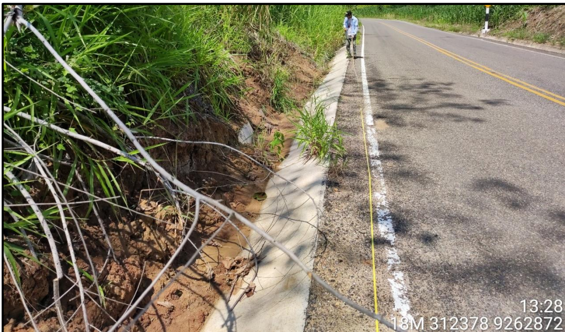
Figura 20. Peladura y Desprendimiento de Agregados – km 7+810
