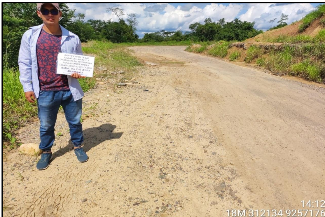
Figura 29. Peladura y Desprendimiento de Agregados – km 15+720
