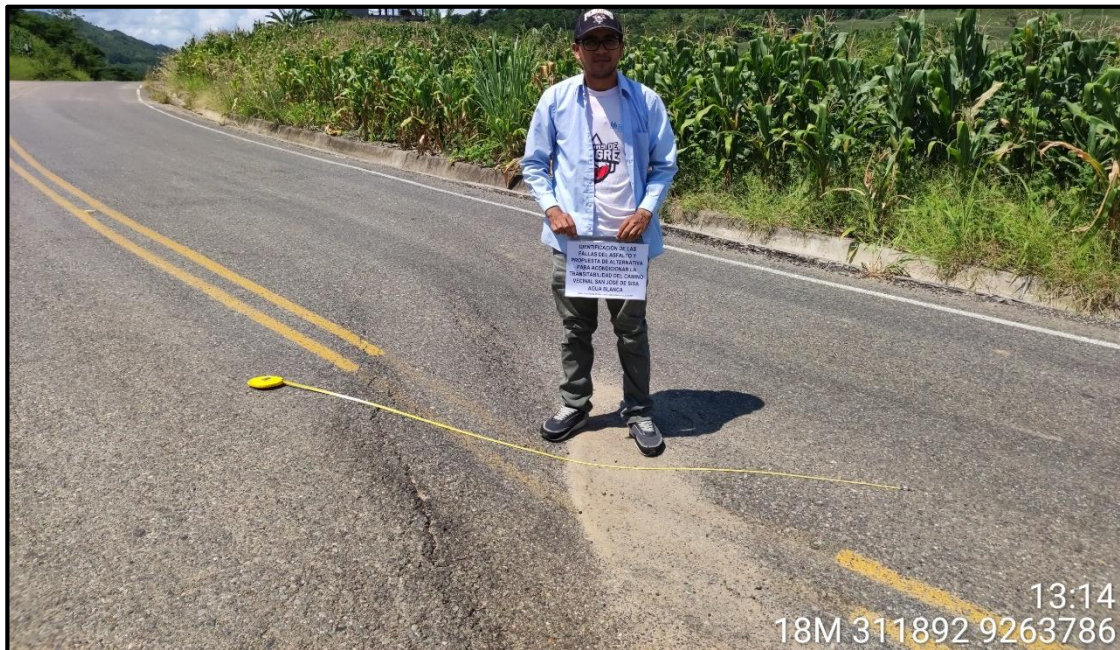
Figura 17. Deformaciones por Deficiencia Estructural (Hundimiento) – km 6+520
