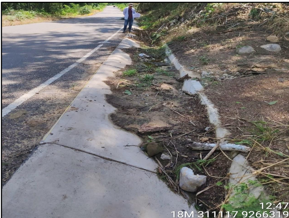
Figura 10. Peladura y Desprendimiento – km 3+040
