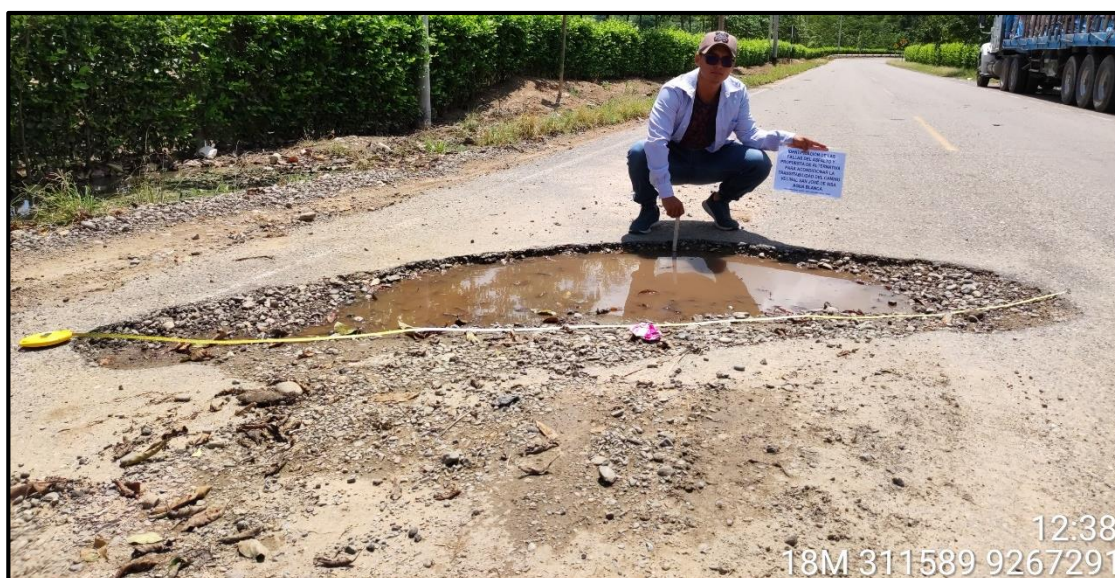
Figura 8. Peladura y Desprendimiento – km 1+400
