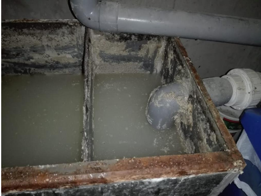
Fotografía 1. Ingreso de trampa de grasas
