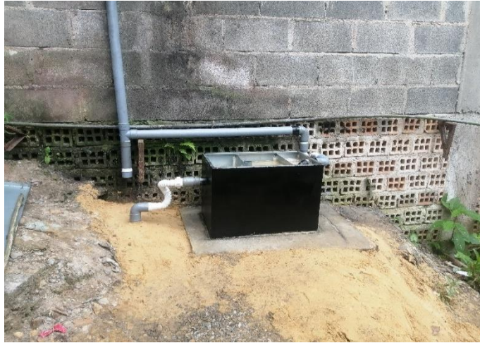
Fotografía 13. Planta general del sistema de tratamiento.
