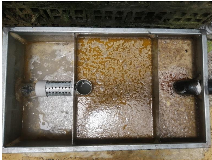
Fotografía 9. Funcionamiento del sistema.
