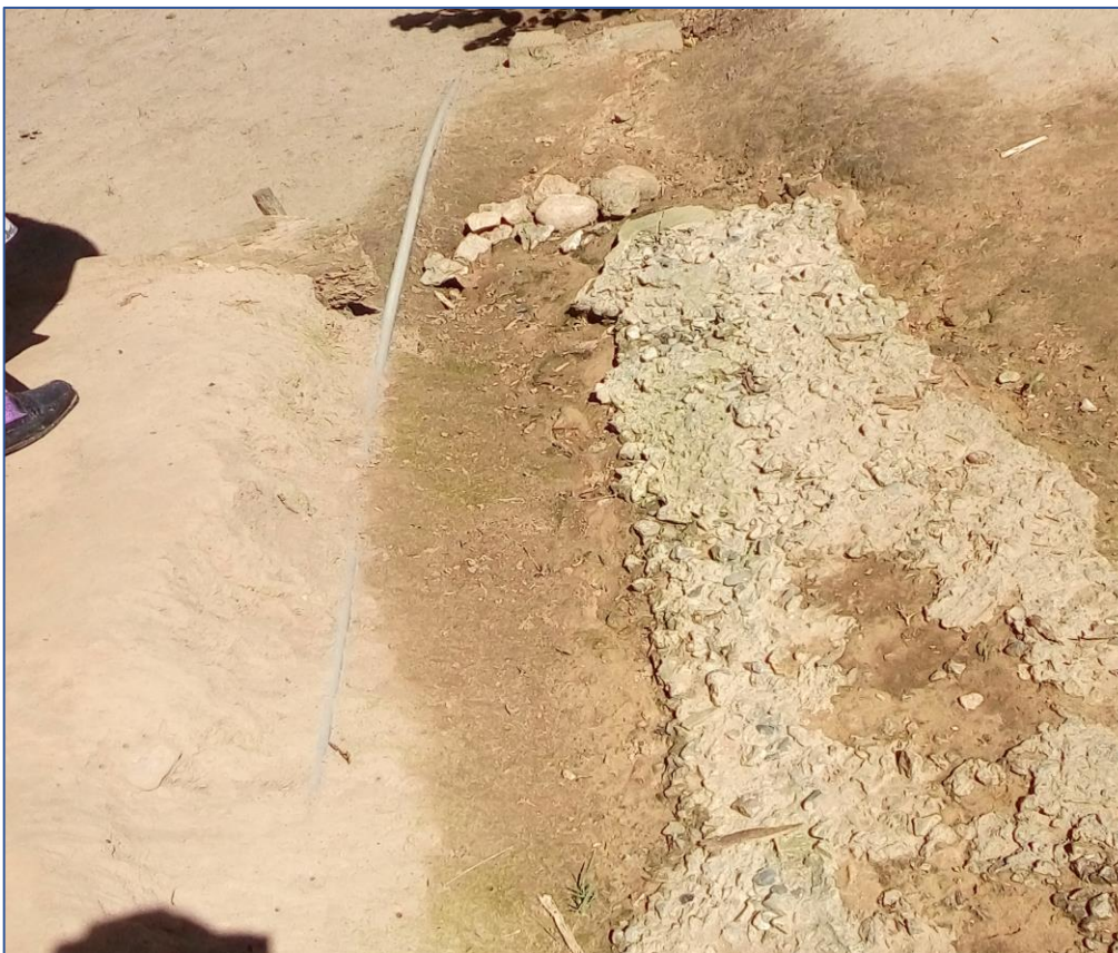
Fotografía 2. Estado de la red de distribución.
