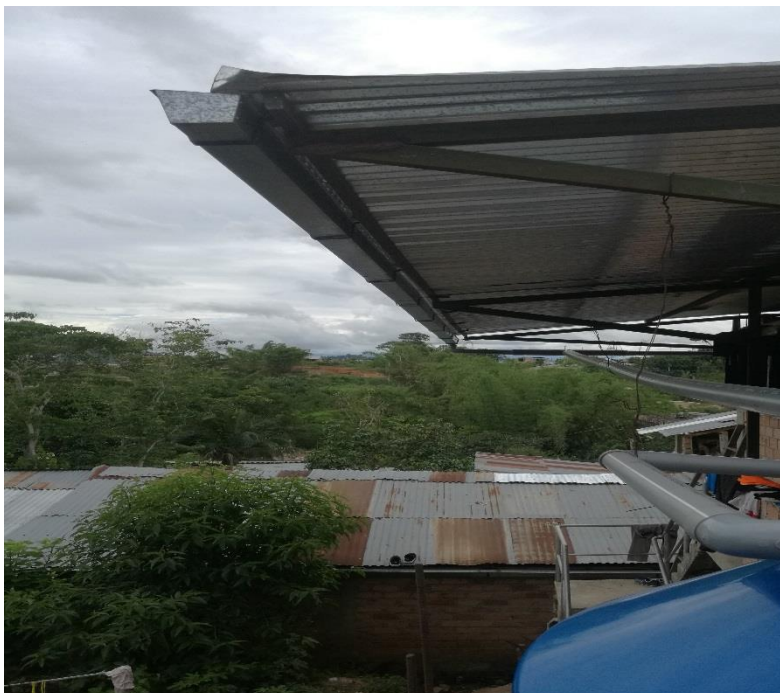
Fotografía 1: Canaleta de recolección de Agua de Lluvia
