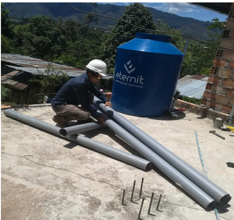
Fotografía 2: Tubería de Conducción de Agua de Lluvia.
