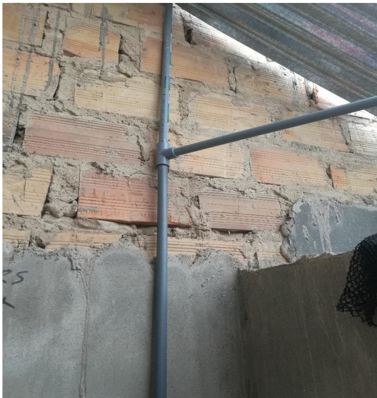
Fotografía 5: Distribución del Agua de Lluvia
