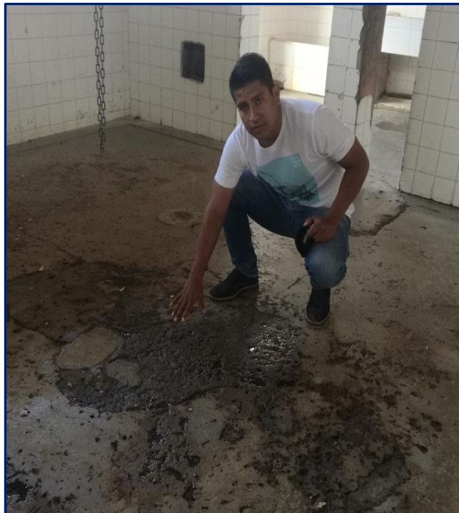
Fotografía 3. Piso de concreto deteriorado
