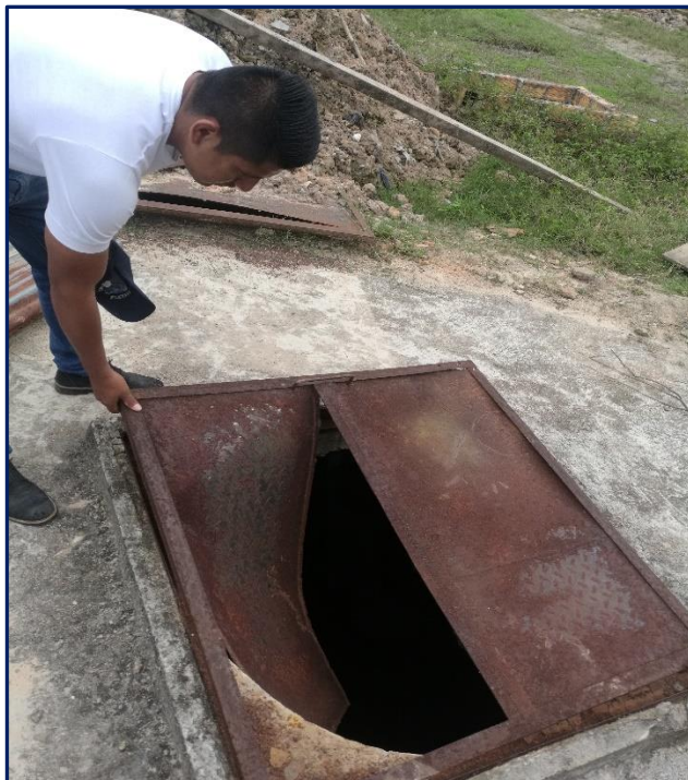
Fotografía 5. Camaras de reunion con tapas deterioradas
