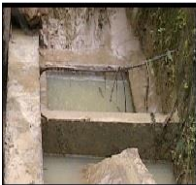
Foto 2: captación del agua
