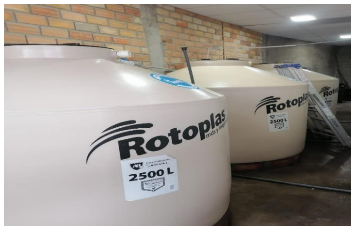
Fotografía 2. Tanques de almacenamiento de agua cruda de 2500 litros
