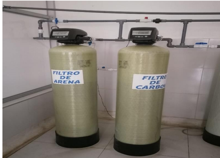
Fotografía 7. FilTROS de arena y carbon activo
