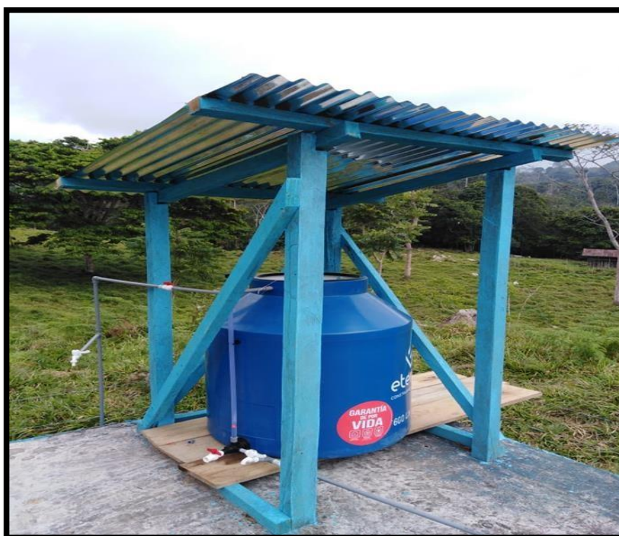
Fotografía 2. Montaje y puesta en marcha del sistema de cloración por goteo
