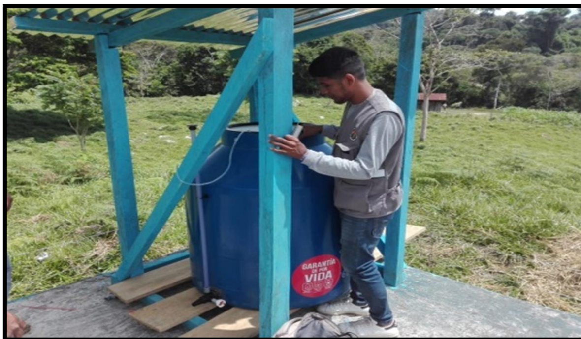
Fotografía 1. Instalación del sistema de cloración por goteo
