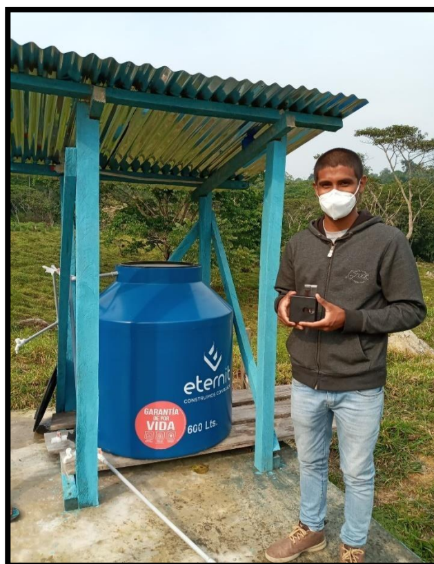
Fotografía. Monitoreo del cloro residual en el Reservorio
