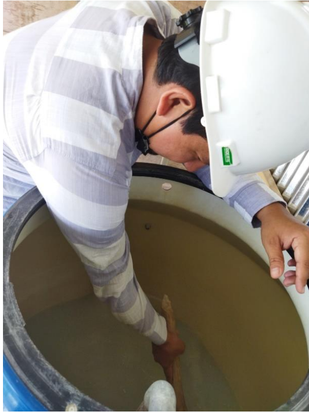
Fotografía 5. Dilución de cloro en tanque de cloración
