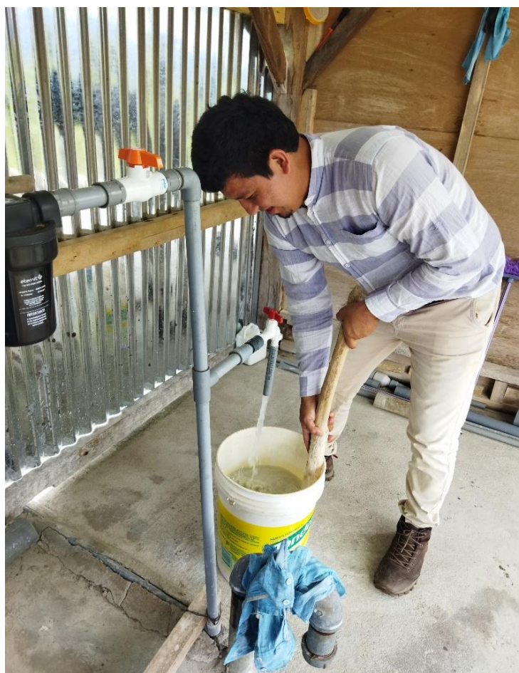
Fotografía 3. Preparación del cloro para vertimiento al Reservorio.
