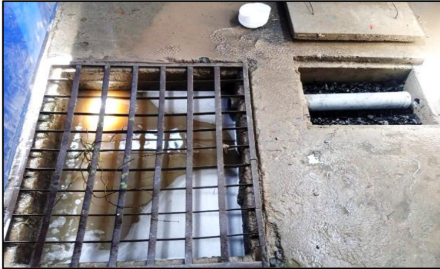
Figura 6. Sistema de tratamiento (trampa de grasa más filtro)
