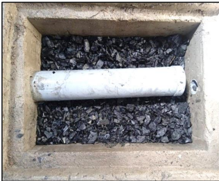
Figura 7. Filtro de grava, arena y carbón activado
