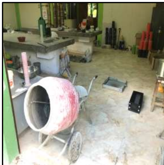
Foto 96: Preparamos los agregados, la ceniza y el trompo para obtener la mezcla.
