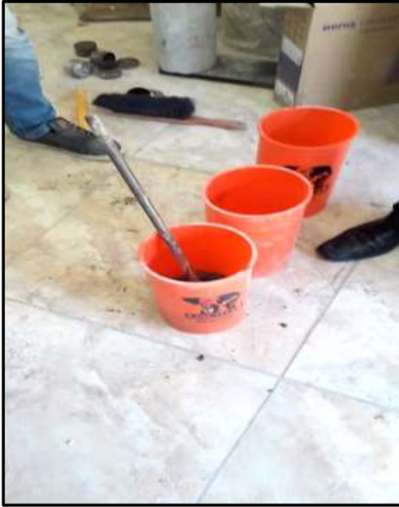
Foto 59: Procedemos al llenado de las probetas en tres capas realizando golpes con martillo de goma.
