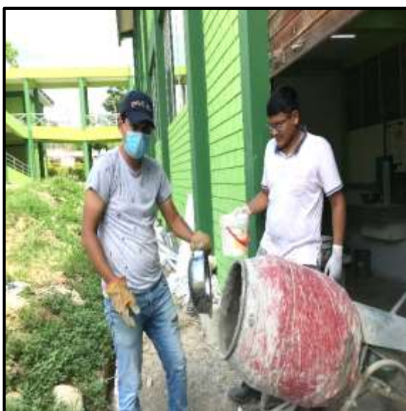
Foto 97: Ingresamos los agregados al trompo para obtener la mezcla repitiendo los pasos anteriormente descritos.
