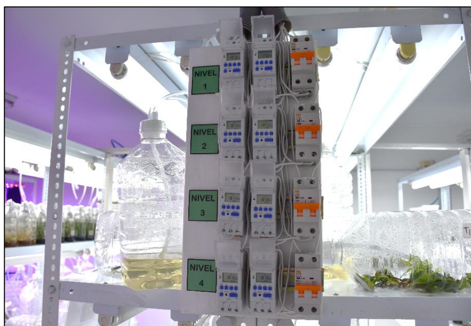
Figura 41. Tablero de control ON/OF, donde se programó el experimento
