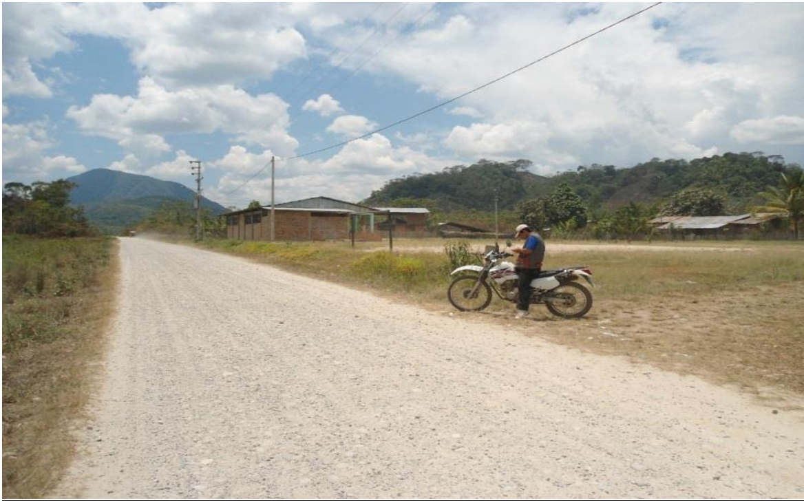
Fotografía N°01: Inicio del Tramo en estudio EMP.SM-638(El Milagro) - Pedro Pascacio Noriega - Campo Alegre - EMP.PE-5N (San José Del Morro), presenta la pérdida de la carpeta de rodadura, (km 00+000).
