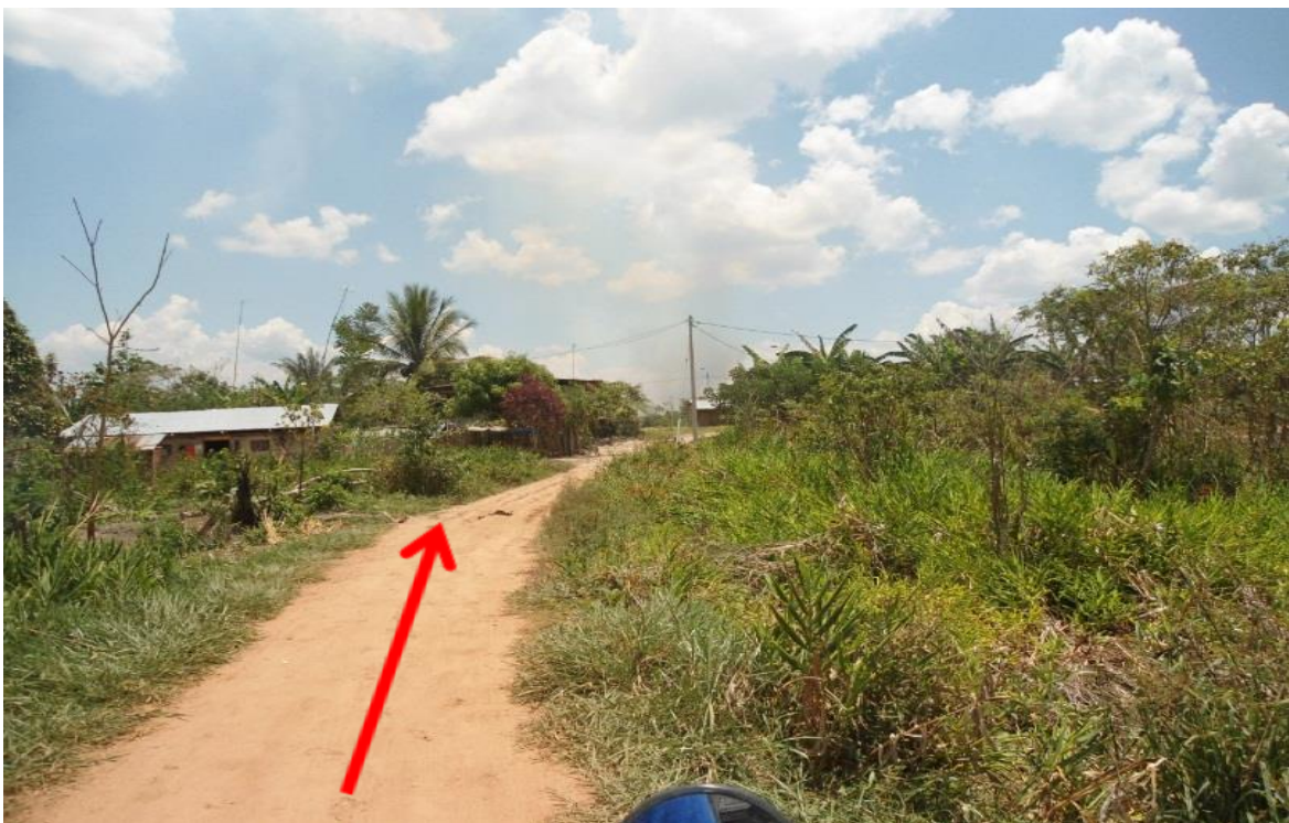
Fotografía N°02: Se aprecia la erosión del ancho de plataforma, donde existen baches, convirtiéndose en Zona Inundable, será necesario la construcción una Alcantarilla HDPE Long.=11.00m, d=42", (km 00+140.00), Zona Crítica.
