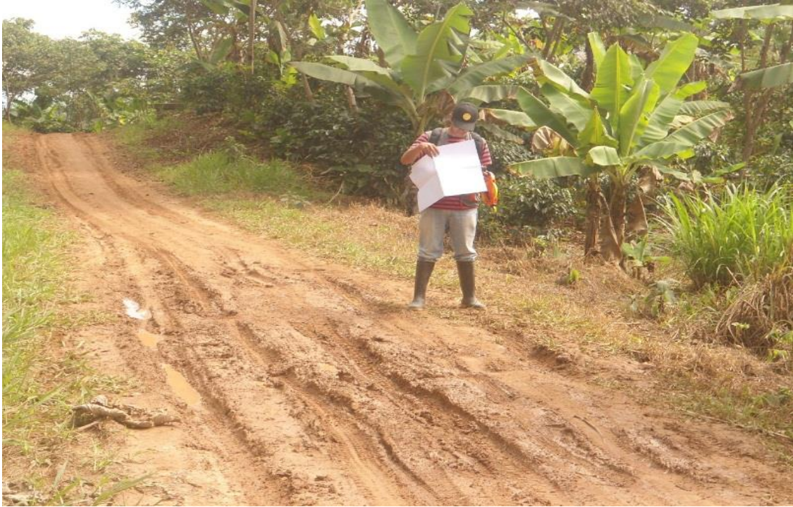
Fotografía N°03: Se aprecia la erosión del ancho de plataforma con baches y encalaminados, será necesario la construcción de una Alcantarilla HDP. Long.=8.00m, d=36", (km 00+503.00), Zona Agrícola.
