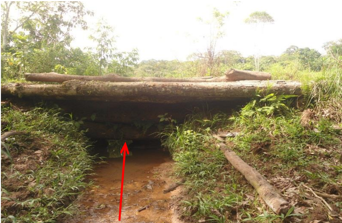
Fotografía N°04: Se muestra el Cruce provisional de madera en estado regular (Zona Inundable, en épocas de lluvia), será necesario la construcción de una Alcantarilla HDPE d=60" (2 ojos), Long.=10.00m (Km 1+566.00).
